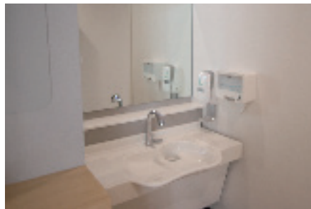
自動水栓の洗面台を完備。車椅子でも使いやすい仕様に
