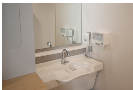
自動水栓の洗面台を完備。車椅子でも使いやすい仕様に
